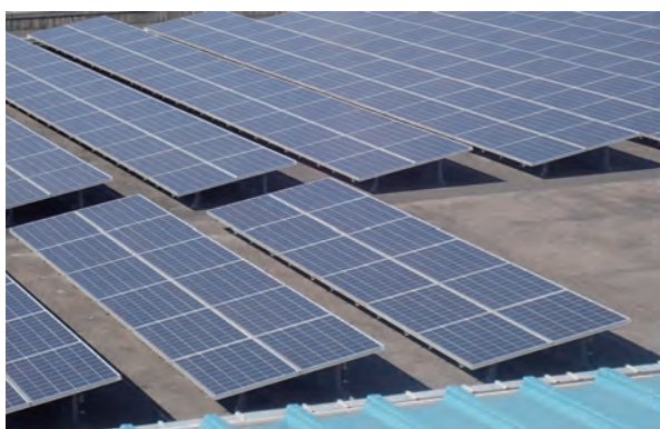
太陽光発電設備(川井浄水場)
