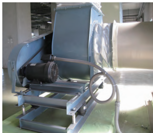
高効率モータ使用機器(送排風機)
