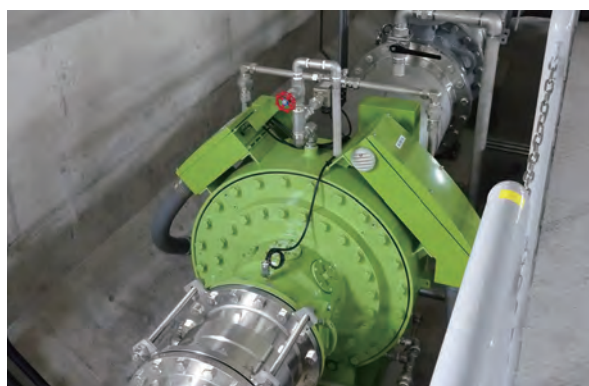
小水力発電設備(今井配水池)
