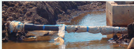
東日本大震災の津波にも耐えた耐震管 (H23年仙台市水道局提供)
